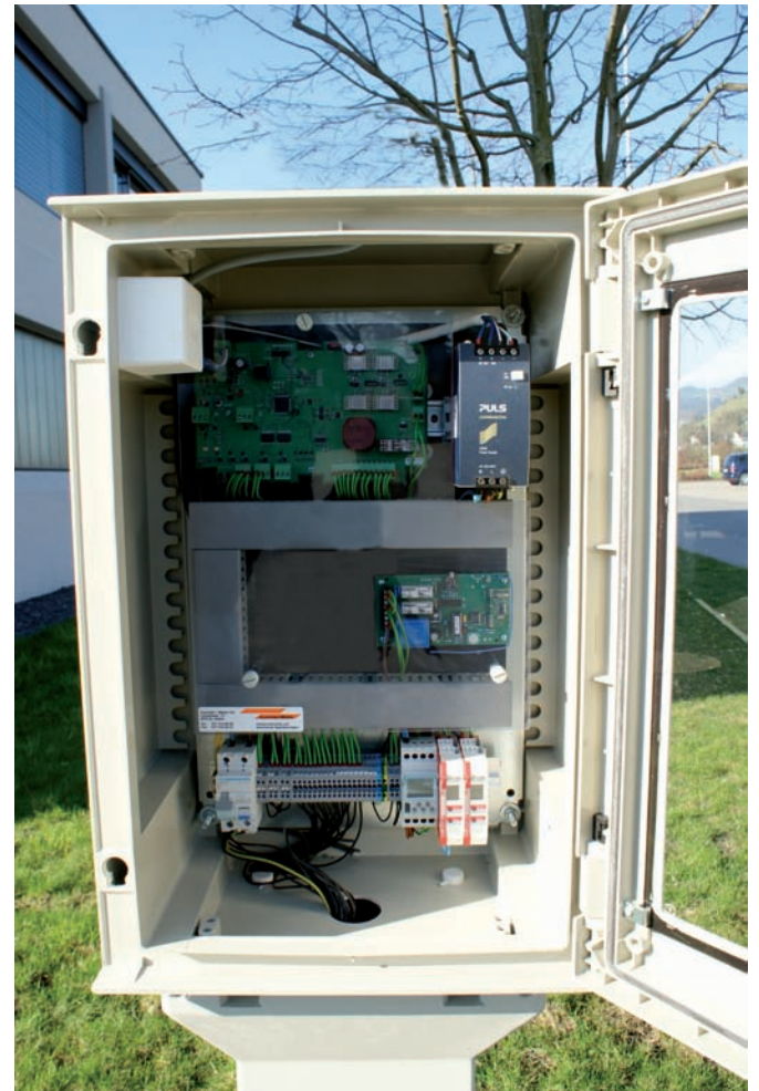
Der Steuerkasten als freistehende Aussensäule konzipiert.
