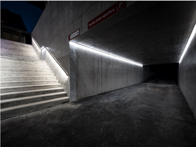
Stazione ferroviaria Sembrancher (sottopassaggio: LaneLED WALL, scala: LaneLED INOX42)
